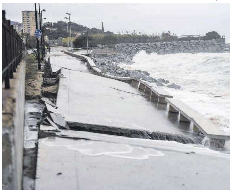
El paseo marítimo de Badalona, gravemente dañado por el fuerte oleaje.
