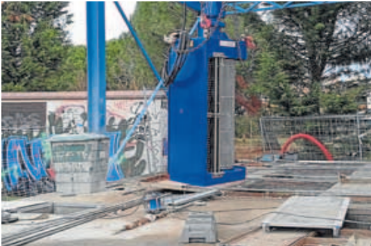
Tritradora en la Estación de Bombeo de Aguas Residuales. EL NORTE
