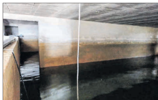
Interior del pozo afectado.
